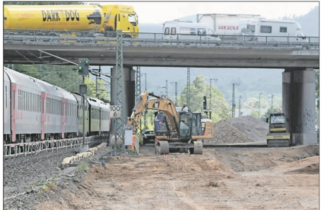
Erster Streich im Gesamtprojekt: Bei Niederbühl wird die Grundwasserwanne zur Unterquerung der Autobahn errichtet.
